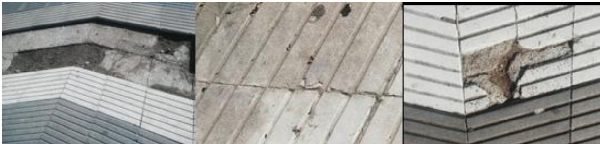
Figura 4: Baldosas faltantes (izquierda), acumulación de polvo (centro), roturas (derecha)
