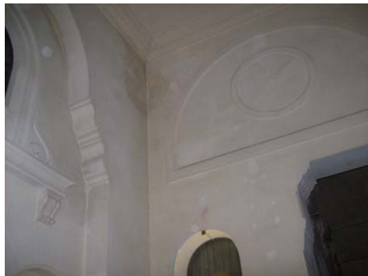
Foto 17: Humedad descendente. Por filtraciones desde el exterior (cornisas) Distintas restauraciones practicadas.
