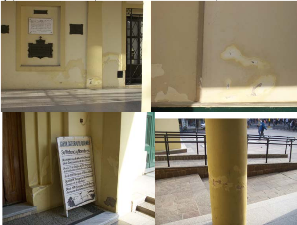
Foto 13: Frente exterior de la Iglesia. Humedad ascendente y efloración de mampostería producto de otras intervenciones ya sea en paredes, columnas y zócalos.
