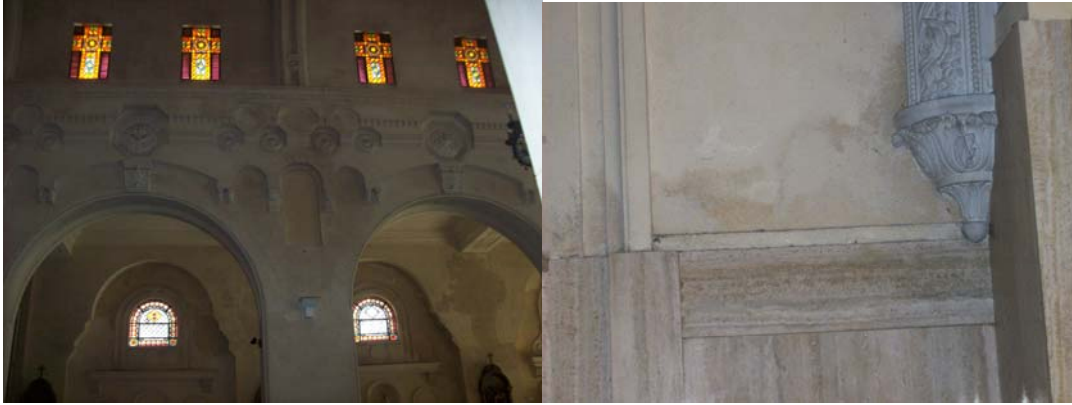
Foto 15: Interior Atrio. Humedad ascendente. Paredes mármoles. Paneo del Atrio sobre calle Mitre. Distintas patologías. Vitrales.
