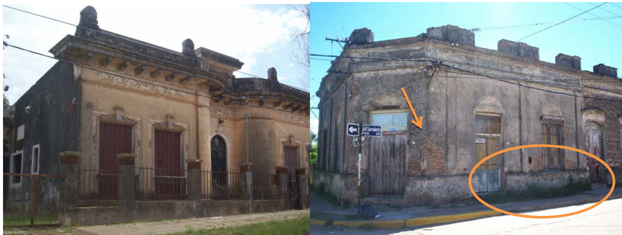
Figura 3: Ataque de microorganismos, crecimiento biológicos, desprendimiento de revoques.
