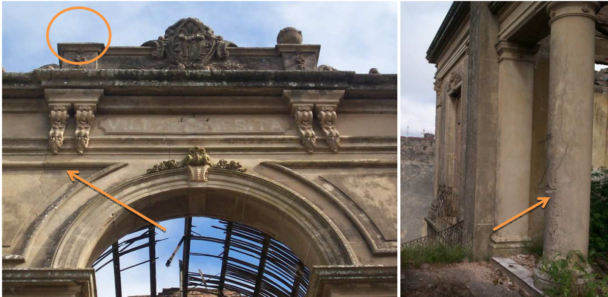
Figura 8: Importante grado de fisuración de elementos portantes, deprendimiento de ornamentaciones.
