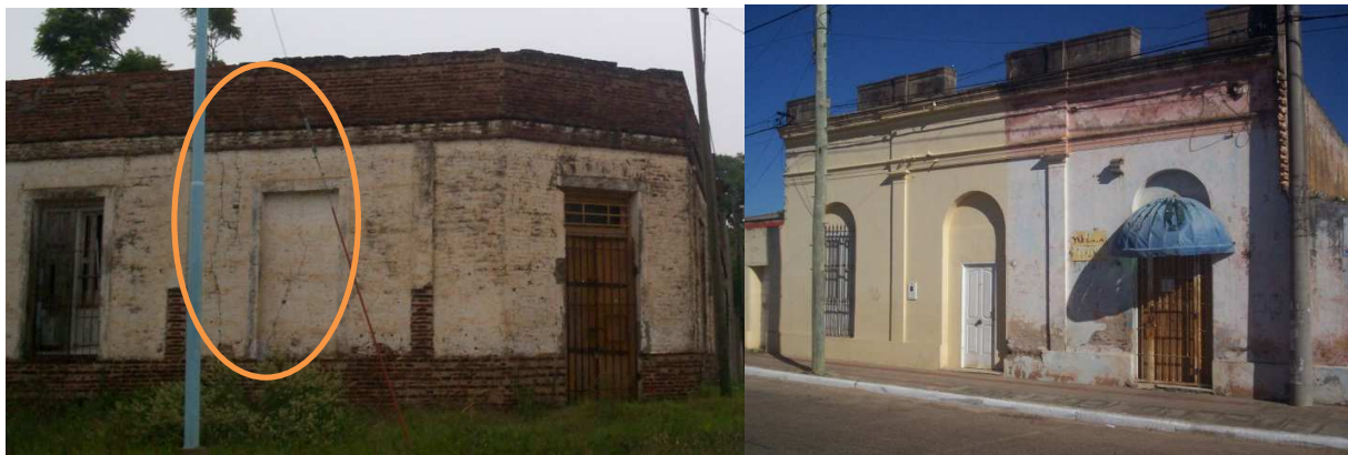
Figura 7: Formación de fisuras, desprendimientos de revoques.
