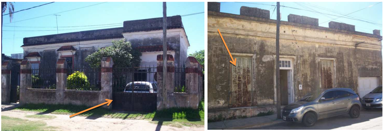
Figura 6: Corrosión de elementos metálicos, desmejoramiento de cerramientos
