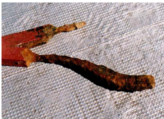
Figura 7 – Estado de la pieza que dio origen a la falla de la estructura
