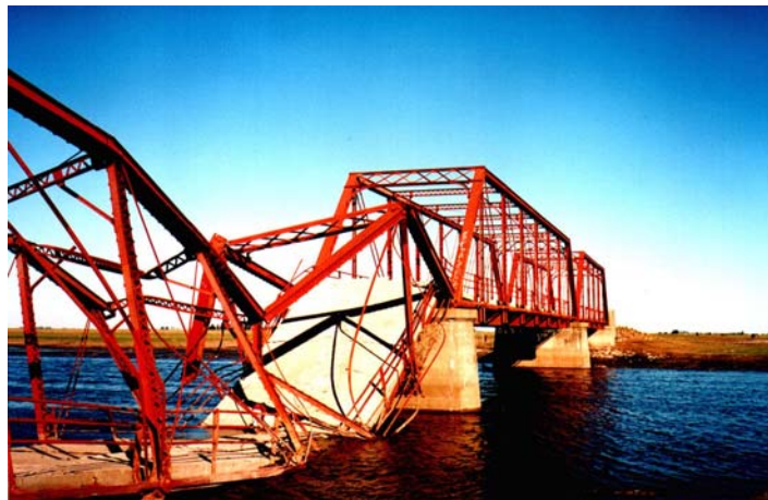
Figura 6 – Estructura colapsada del puente emplazado sobre el río Samborombón
