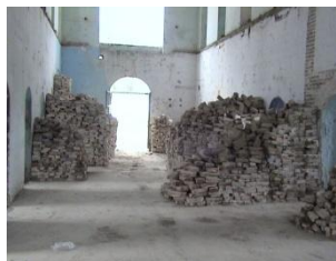
Fig.18 Liberación muraria no original.
