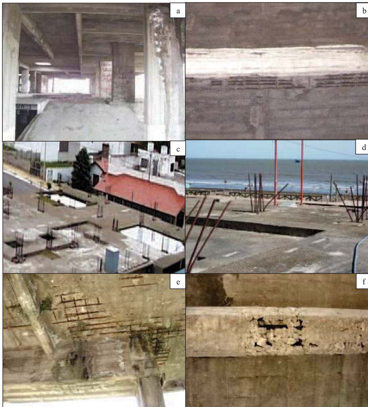
Figura 2: Relevamiento de la estructura. a: vigas, losas y columnas internas. b: vigas corroídas en sectores cercanos al hueco de escalera. c y d: acumulación de agua de lluvia en los sectores de bajo losa del primer piso. e: superficie inferior de losas. f: coquera en viga.
