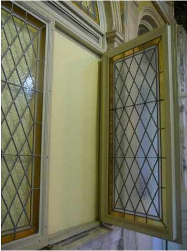
Vitral de reposición de faltante con vidrio translúcido y pared de fondo intervenida
