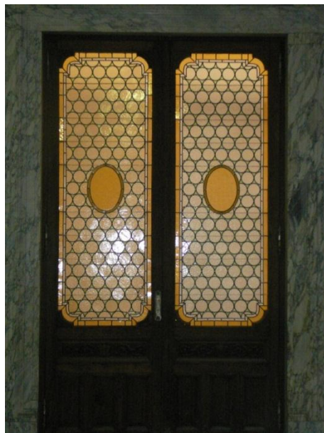
Paño de la izquierda original con vidrios amarillo limón Paño de la derecha reposición con vidrios translúcidos
