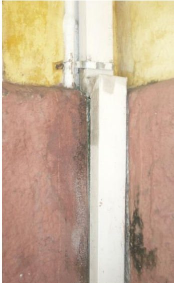
Figura 3 - Manchas de umidade próximas às calhas. Foto: Camilla Maia
